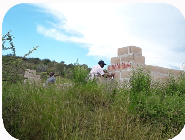
Mkurugenzi Msoleni Dakawa akisimamisha ujenzi katika moja ya nyumba zilizojengwa bila kibali cha ujenzi
